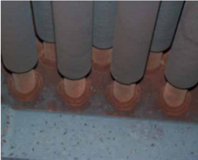
Bild 2-7. Schweißnähte von Rohr-Sammelrohr im vorderen HD-Überhitzer
