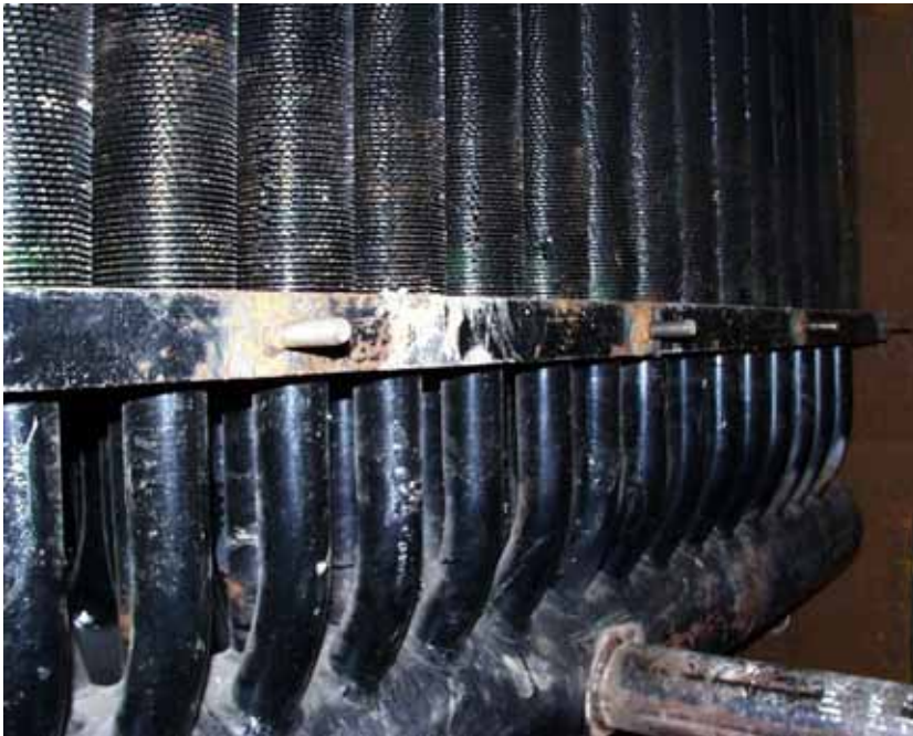
Bild 2-6. Biegungen der Rohre zum unteren Sammelrohr in einem MD-Verdampfer
